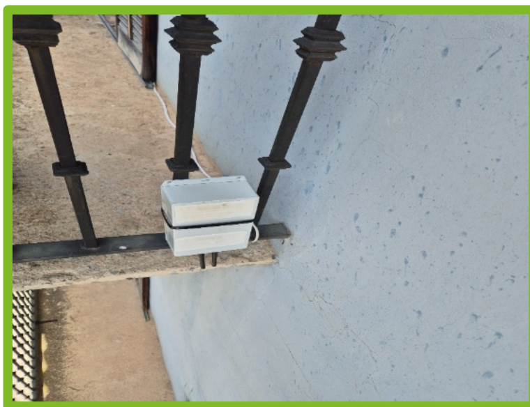
Nodo instalado en Tudela, Plaza Yehuda Ha Levi
